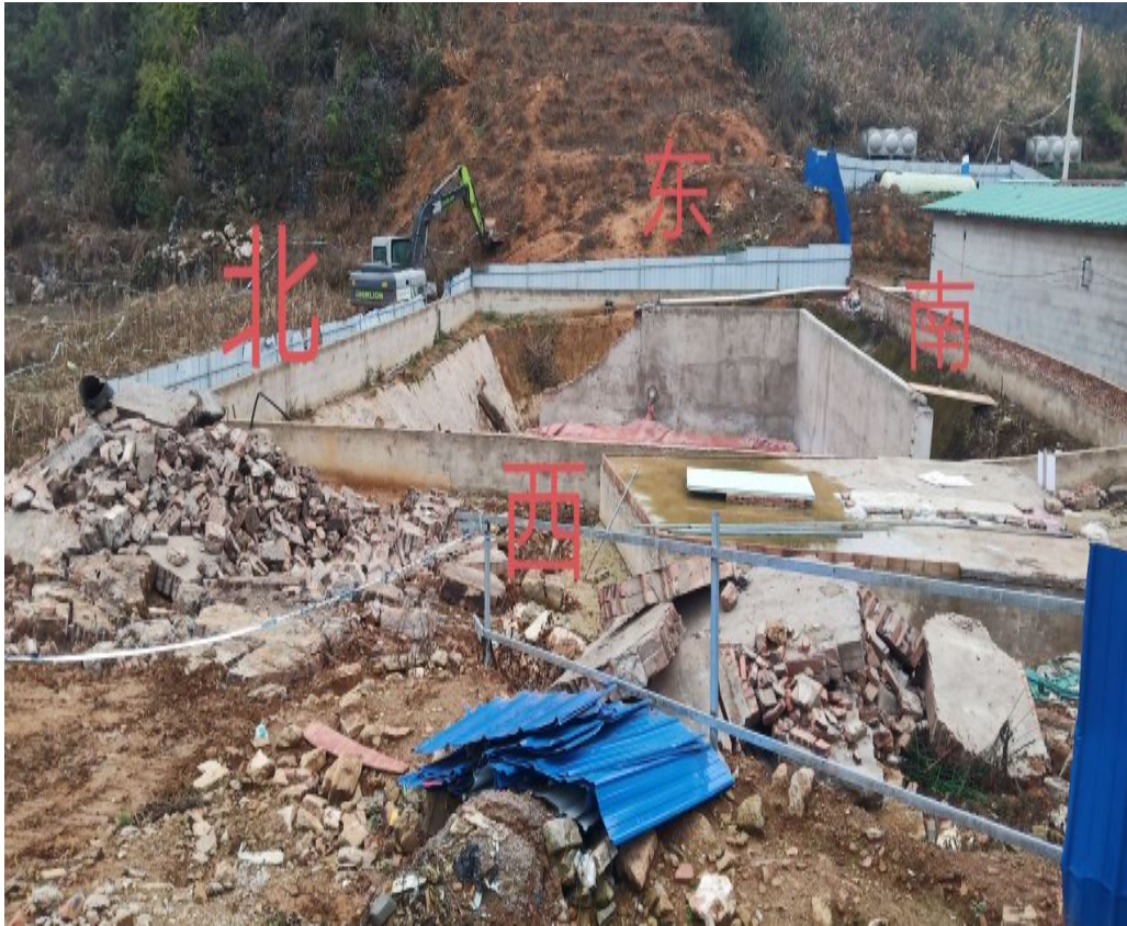
事故现场概貌
